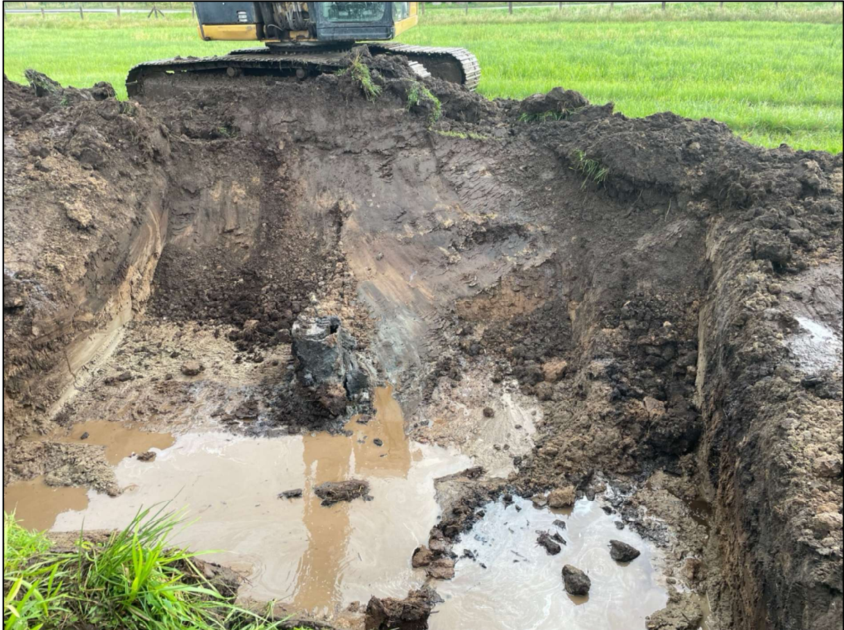
Abbildung 7: Freilegung der Bohrung Holstein 23 am 17.09.2025 mit Ölschlieren auf der Baugrubensohle
